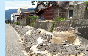
液状化現象により隆起した道路とマンホール
